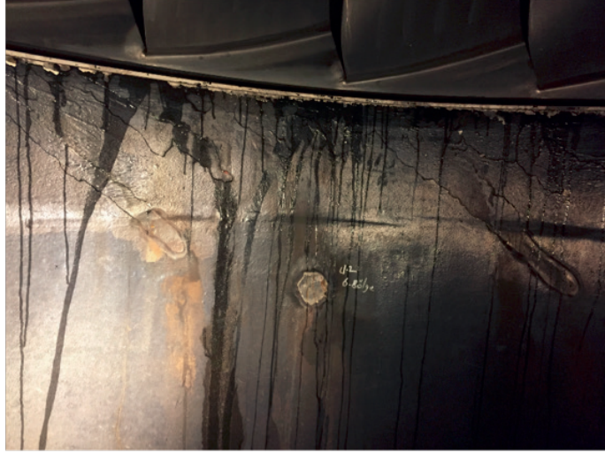
Şekil 11. Ünite emme borusu bölgesindeki kavitasyon hasarı izleri.
